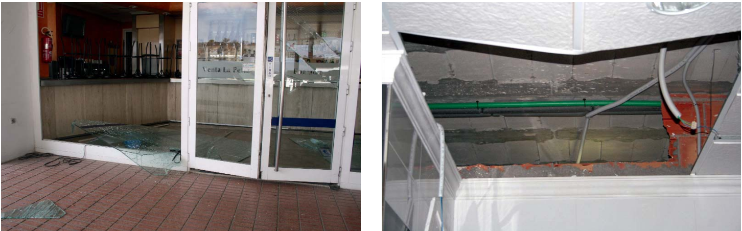
Figura 9. Daños ocasionados por la sobrepresión sobre elementos de la gasolinera. Fuente: Autores.
